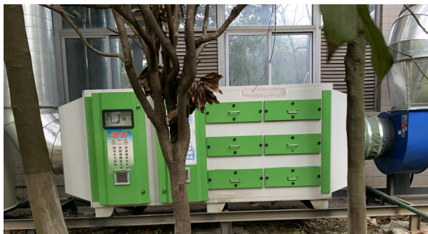
喷淋+干燥棉+二级活性炭吸附处理+排气筒（DA001）
