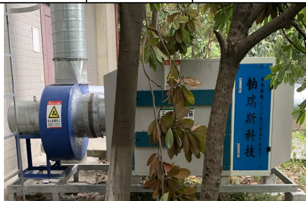
二级活性炭吸附处理+排气筒（DA002）15m
